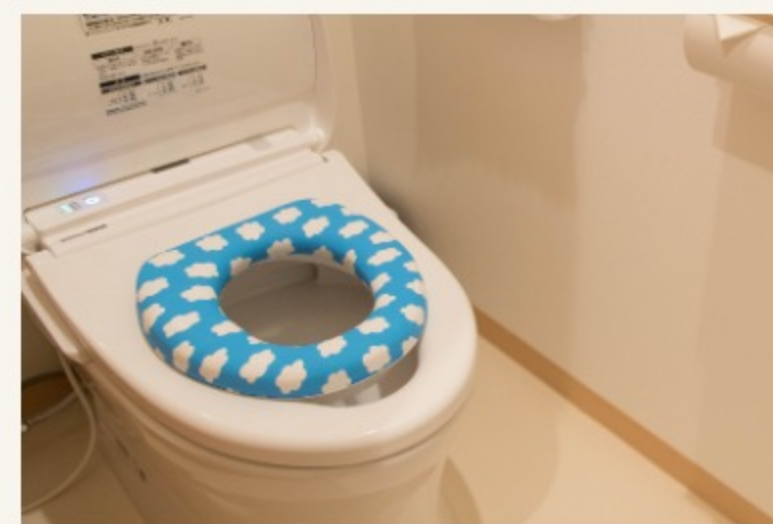
小さなお子様のトイレをサポートする子供用便座を設置しております。
